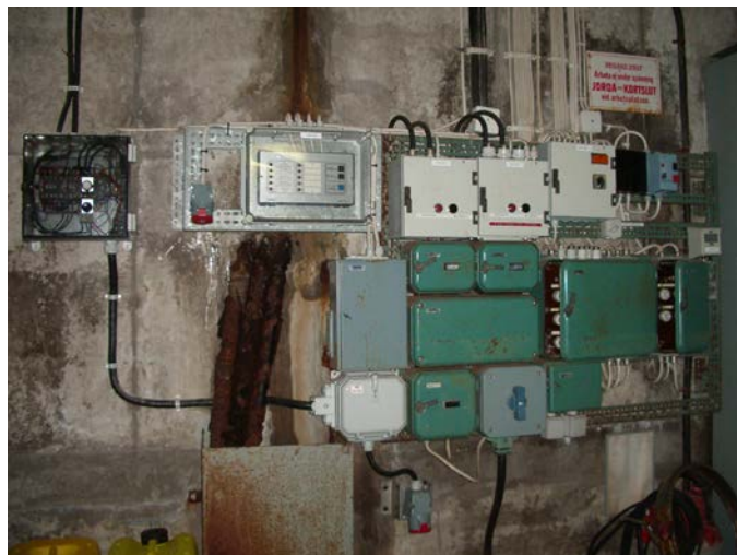
Elcentralen i maskinrummet
