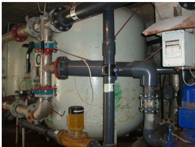
Sandfilter i maskinrummet
